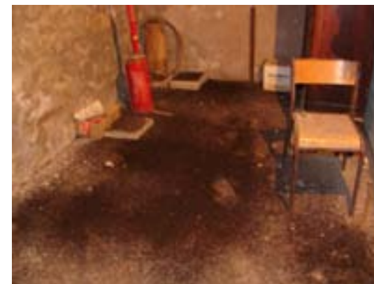
Figure 51 : Guano dans la chaufferie de la mairie de Monthureux-sur-Saône (Photo : Michaël Gamarde)
