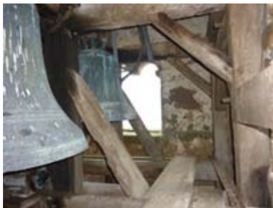
Figure 47 : Ouverture dans le clocher (Photo : Michaël Gamarde)
